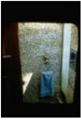
Tiled Bathroom Wall (KA0048_b01_f15_s15)
